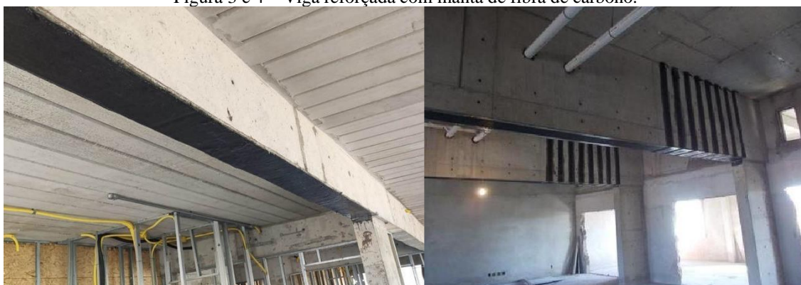
Figura 3 e 4 – Viga reforçada com manta de fibra de carbono.
