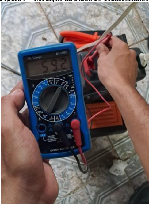
Figura 9 – Medição na Saída do Transformador
